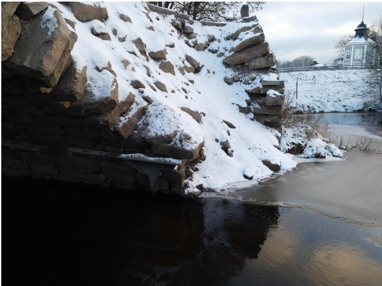
Bild 5 – visar rasområde med den buktande sidomuren samt rester av vederlagsmuren
