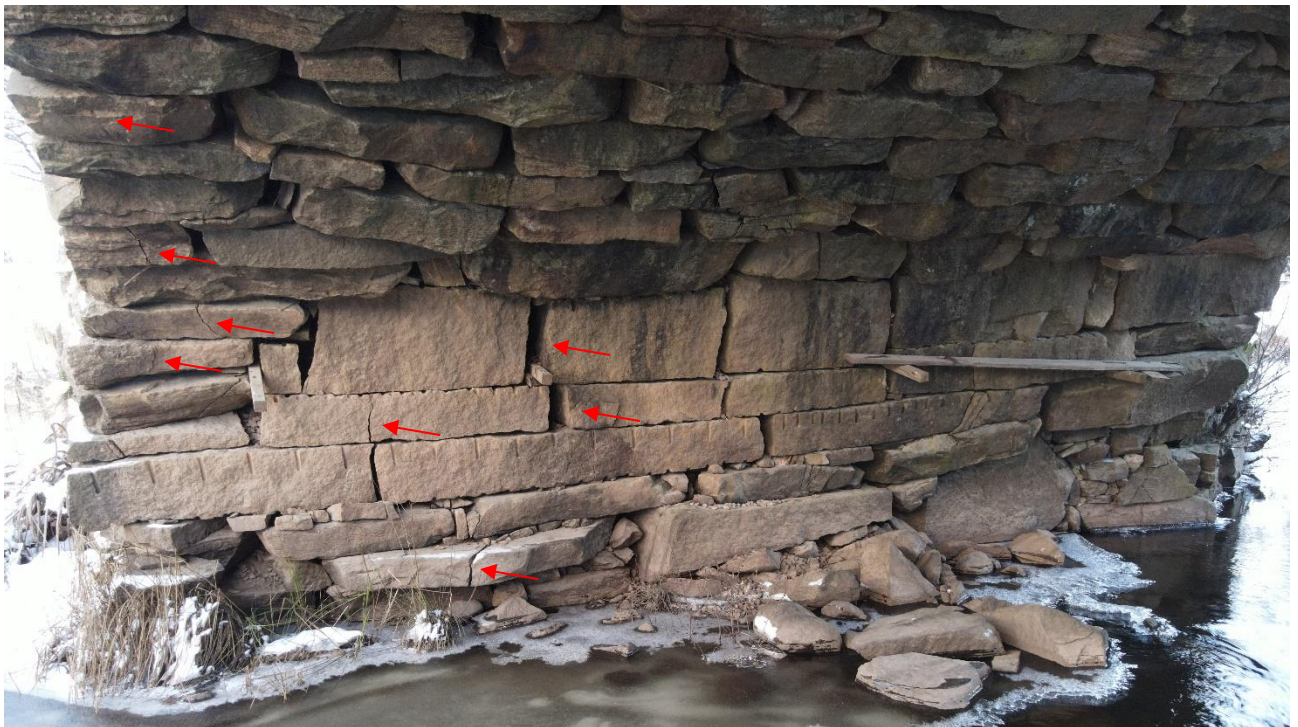
Bild 3 – visar västra vederlaget i östra valvet med där markerade sprickor och glipor kan antyda en sidoförskjutning nedströms liksom som skett i rasområdet
