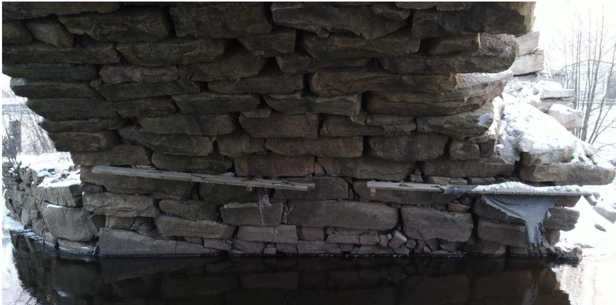
Bild 4 – visar västra valvets östra vederlag där det raserade området syns till höger i bild
