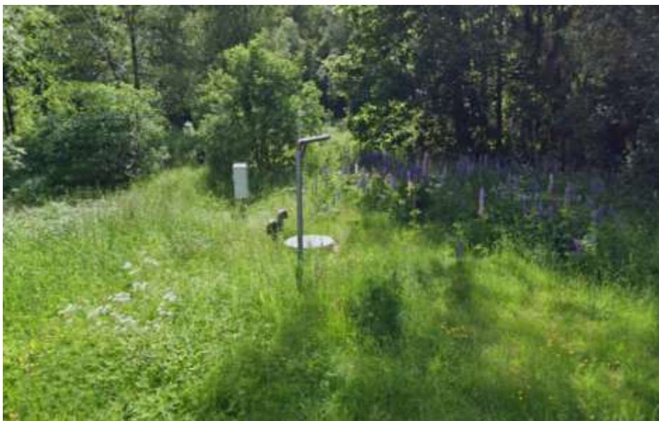
Figur 2. Pumpstation placerad i lokal lågpunkt i slänt som riskerar att påverka pumpstationens funktion vid ett skyfall.
