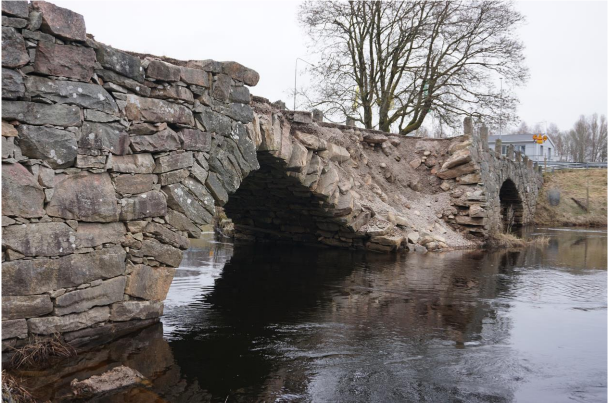
Stenvalvsbron sett från sydväst, del av mittparti samt västra valvet rasade i november 2022.
